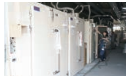
7台がフル稼働(乾燥機)
